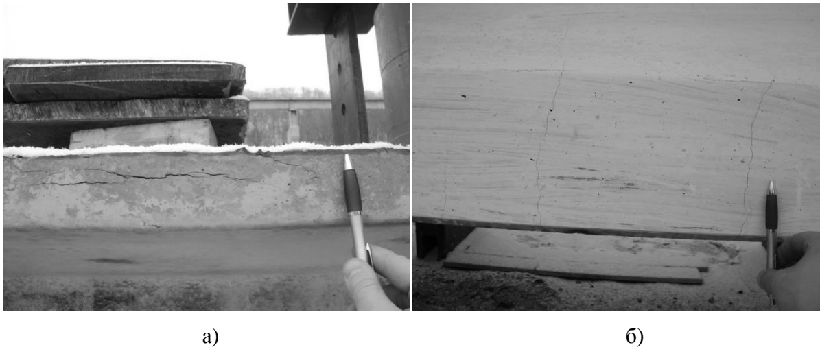
Рис. 3.37. Балка МЗБК-160 при навантаженні 786,5 кН: а – руйнування бетону в стиснутій зоні балки, б – тріщини в розтягнутій зоні балки
