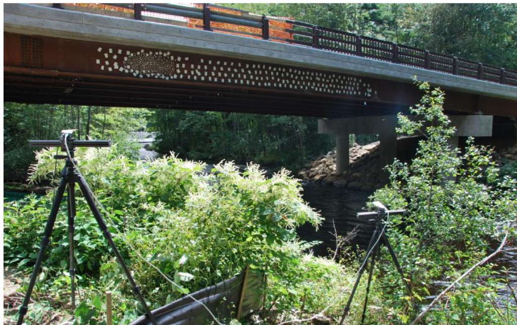
Рис. 1.11. Обладнання ЦКЗ, встановлене на середньому прогоні моста
