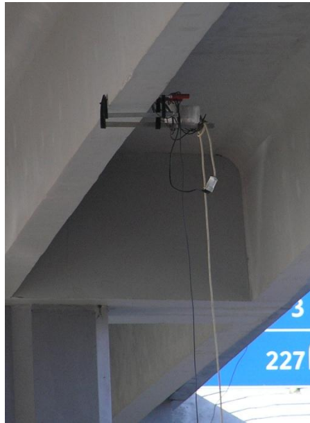
Рис. 5.14. Розміщення датчиків АЕ на прогоновій будові шляхопроводу
