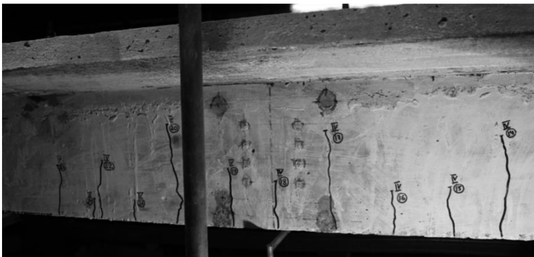
Рис. 3.12. Поширення тріщин 14-24 на балці в прогоні В-С по осі 1 прямолинійної частини дослідної конструкції зовнішньої грані
