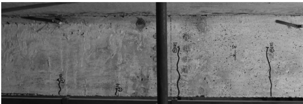
Рис. 3.15. Поширення тріщин 1-4 на балці по осі 2 прямолінійної частини дослідної конструкції на зовнішній грані
