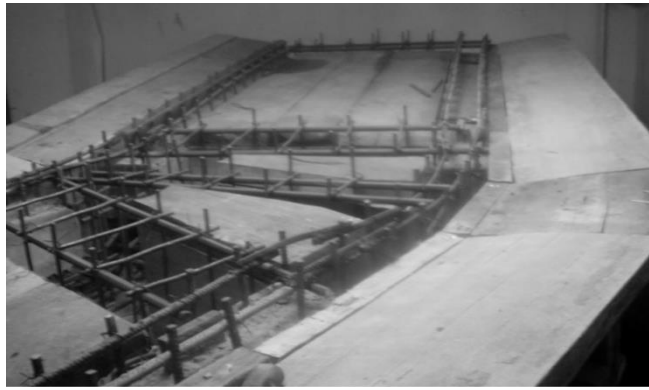
Рис.2.25. Армування і опалубка монолітної надопорної частини прогонової будови дослідної конструкції на криволінійній ділянці
