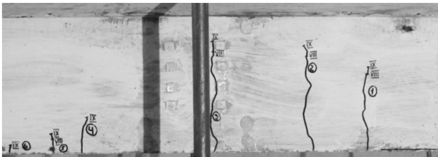
Рис. 3.44. Поширення тріщин на зовнішній грані збірної балки в середині прогону D-E по осі 2 дослідної конструкції
