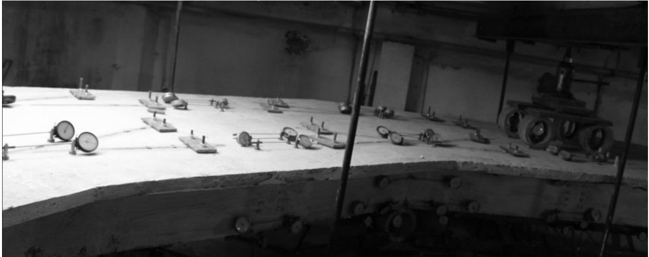
Рис.3.29. Криволінійна частина дослідної конструкції при випробуванні за першою схемою (навантаження прогону D-E)
