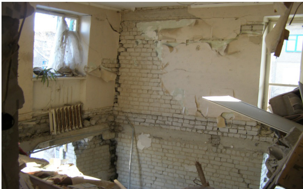
Рис 3.8. Обвалені перекриття в осях 4/1 - 5 між осями Б-Г над другим і третім поверхом Тріщини в кутах будівлі шириною розкриття до 150 мм. Зруйнований захисний шар бетону і оголена арматура в міжповерхових монолітних поясах
