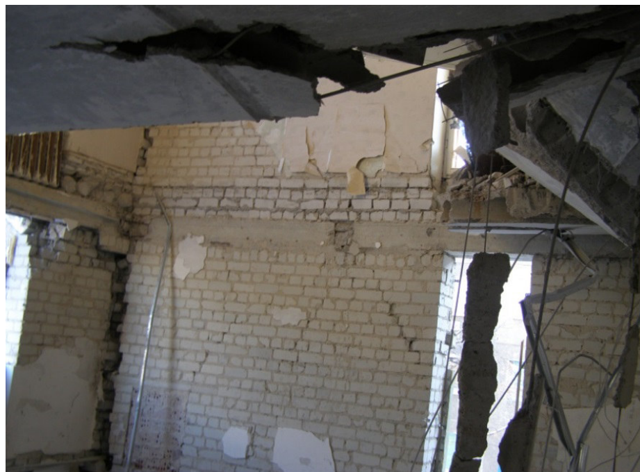
Рис. 3.14. Обвалені перекриття над другим поверхом
