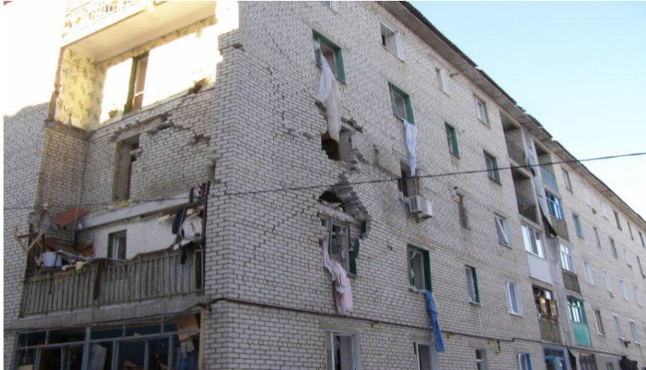
Рис 3.7. Деформована і зруйнована кладка зовнішньої несучої стіни в осях 6-1 по осі Г блок секції №3 житлового будинку №3а з утворенням тріщин з четвертого по другий поверх. Вибиті шибки у вікнах блок секції №3 житлового будинку №3а
