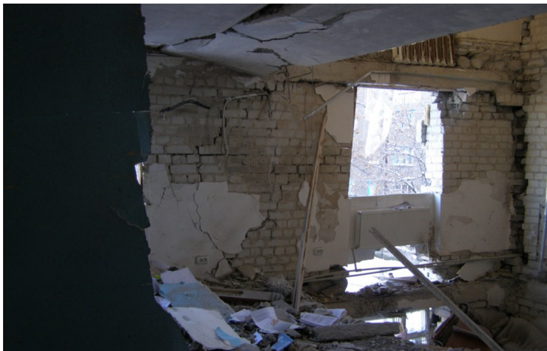
Рис. 3.15. Обвалені перекриття над третім поверхом
