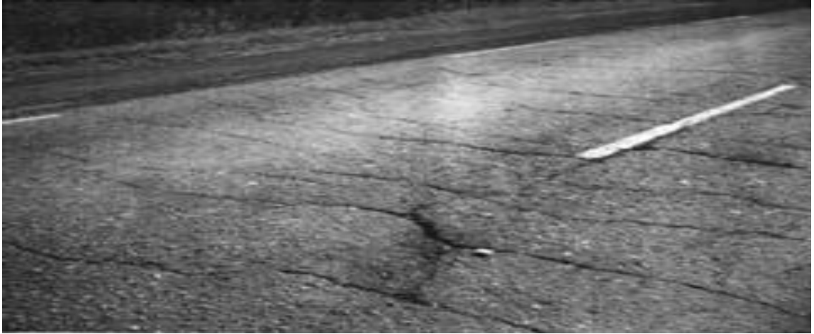
Рис. 4.1. Існуючі деформації та дефекти на ділянці автомобільної дороги Київ-Ковель км 297+700 – км 302+400 (2007 рік)
