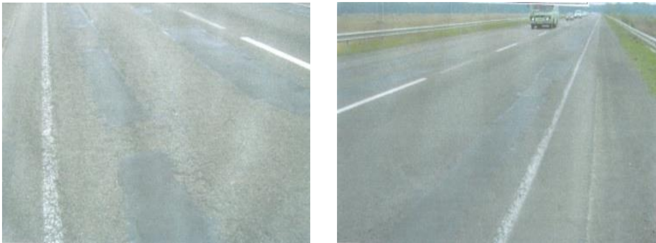
Рис. 4.27 Фотоматеріали дефектів на ділянці автомобільної дороги Київ-Ковель (км 297+700 – 302+400) через 8,5 років після виконання холодного ресайклінгу
