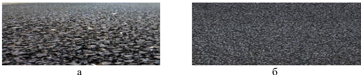
Рис. 4. Загальний вигляд дослідної та контрольної ділянки на автомобільній дорозі III-ї технічної категорії Львів-Тернопіль: а – дослідна ділянка; б – контрольна ділянка
