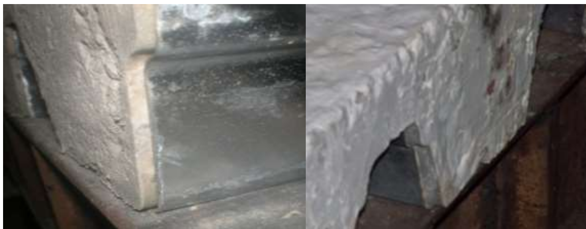
Рис. 3.29. Зміщення бетонного блоку відносно профнастилу
