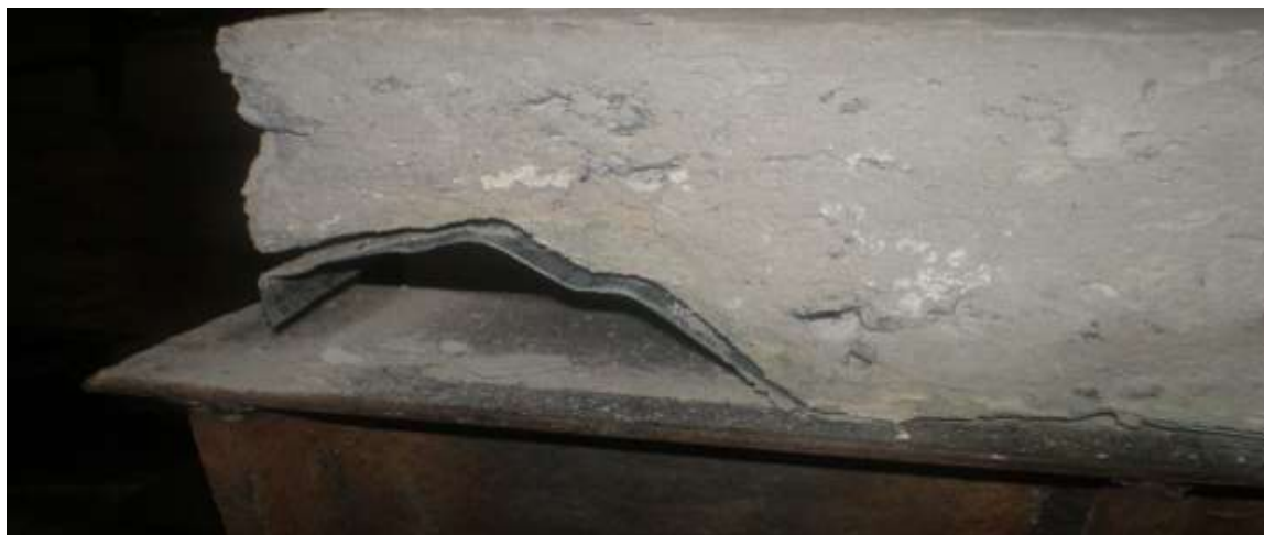
Рис. 3.28. Відшарування листової профільованої арматури в торці конструкції
