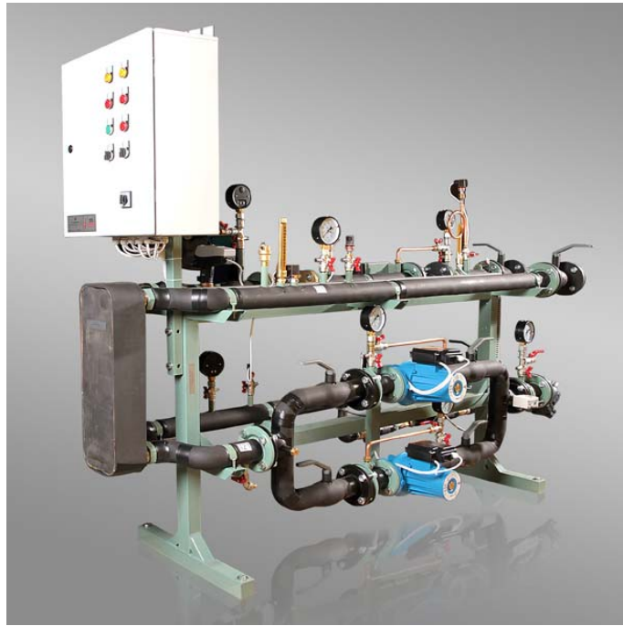
Рис.5.13. Індивідуальний тепловий пункт
