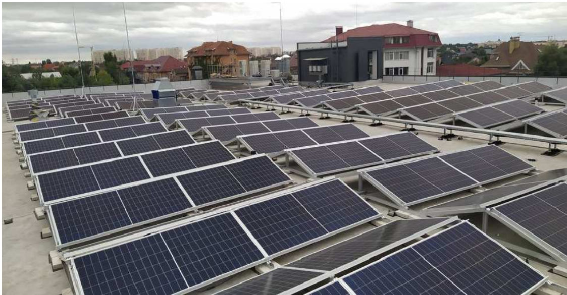
Рис. 2.3. Відновлювальні джерела енергії – станція сонячних батарей
