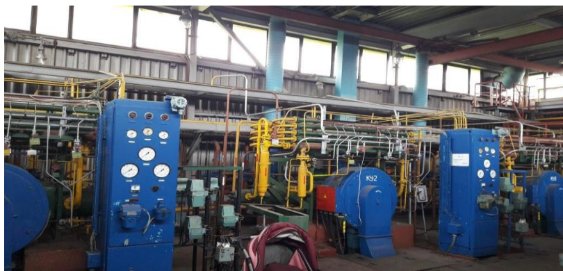
Рис. 2.11. Загальний вигляд компресорного цеху АГНКС-500 з компресорами 2ГМ4-1,3/12-250
