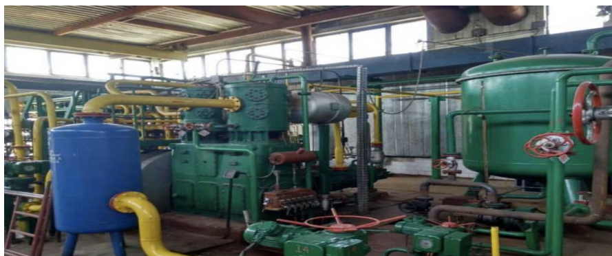
Рис. 2.21. Загальний вигляд машинного залу АГНКС–500 4HR3KN–200/210–5–249WLK
