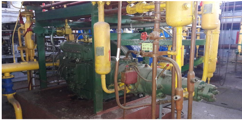
Рис. 2.12. Загальний вигляд компресорної установки 2ГМ4–1,3/12–250
