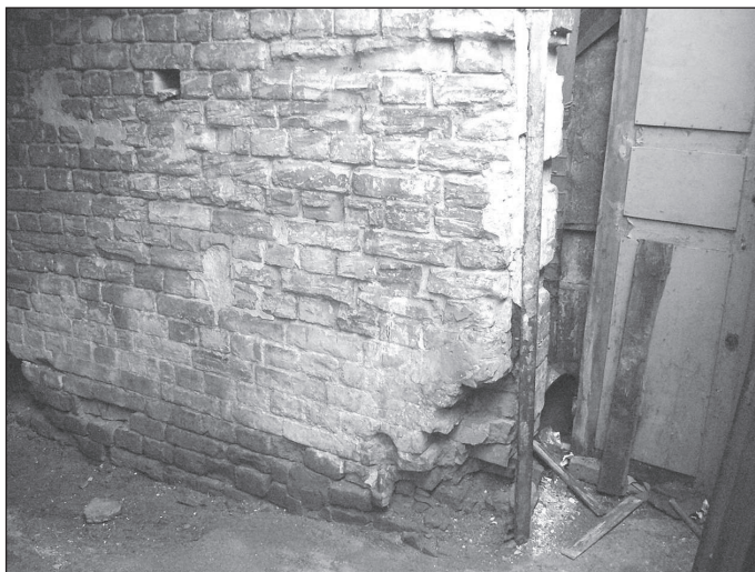
Рисунок 8. Будинок 14А. Руйнування мурування цокольної частини стіни головного фасаду в місці проїзду
