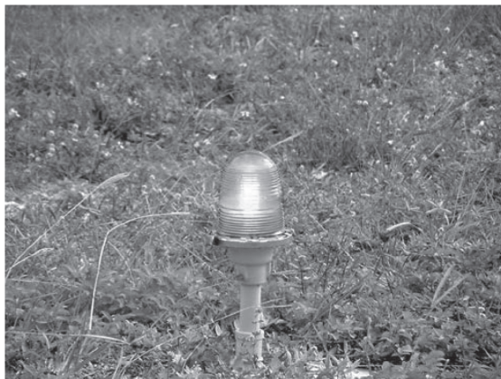
Ilustracja 61. Żółte światło krawędzi drogi startowej
