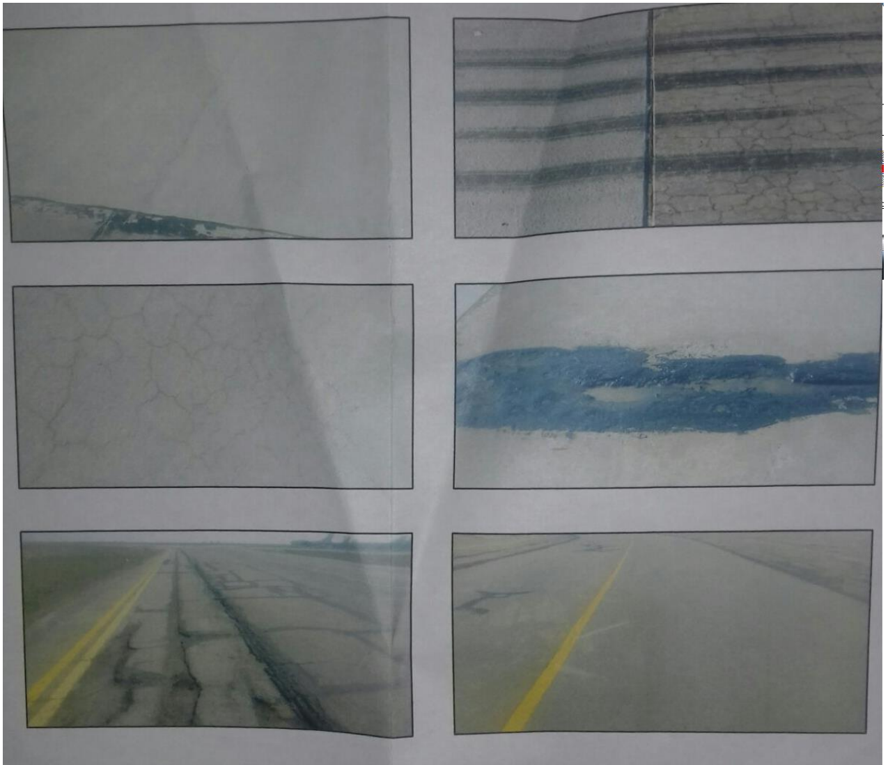
Рис. 1.2. Дефекти аеродромного покриття ШЗПС Міжнародного аеропорту «Запоріжжя»
