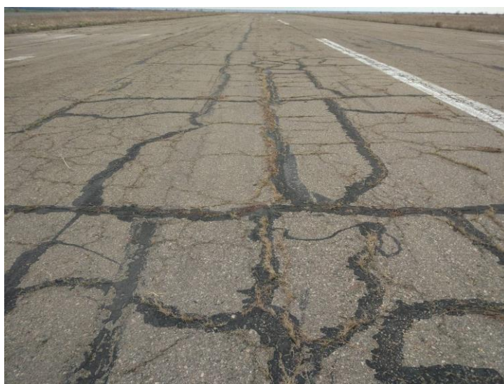
Рис. 2.7. Тріщини на покритті з рослинністю
