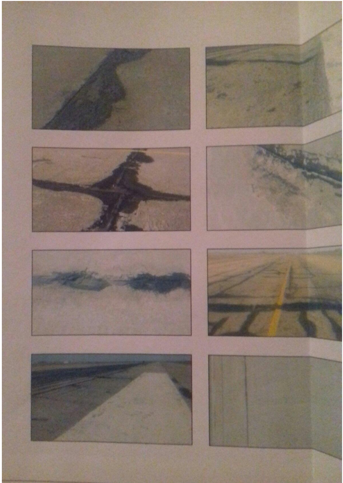
Рис. 1.1. Дефекти аеродромного покриття ЗПС Міжнародного аеропорту «Запоріжжя»
