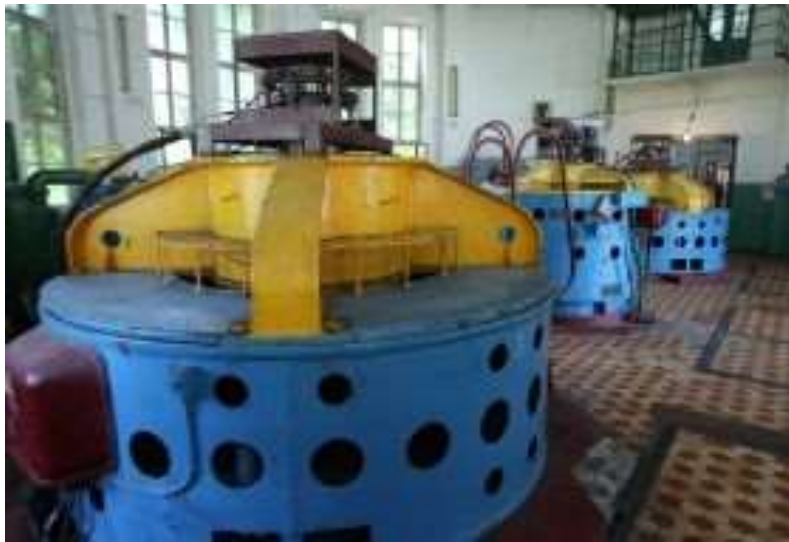
Рис. 4.3 Насосна станція першого підйому
