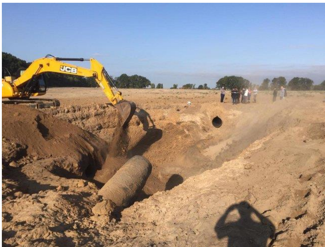
Рис. 2.3. Наслідки аварії на ГТС в Чабанах
